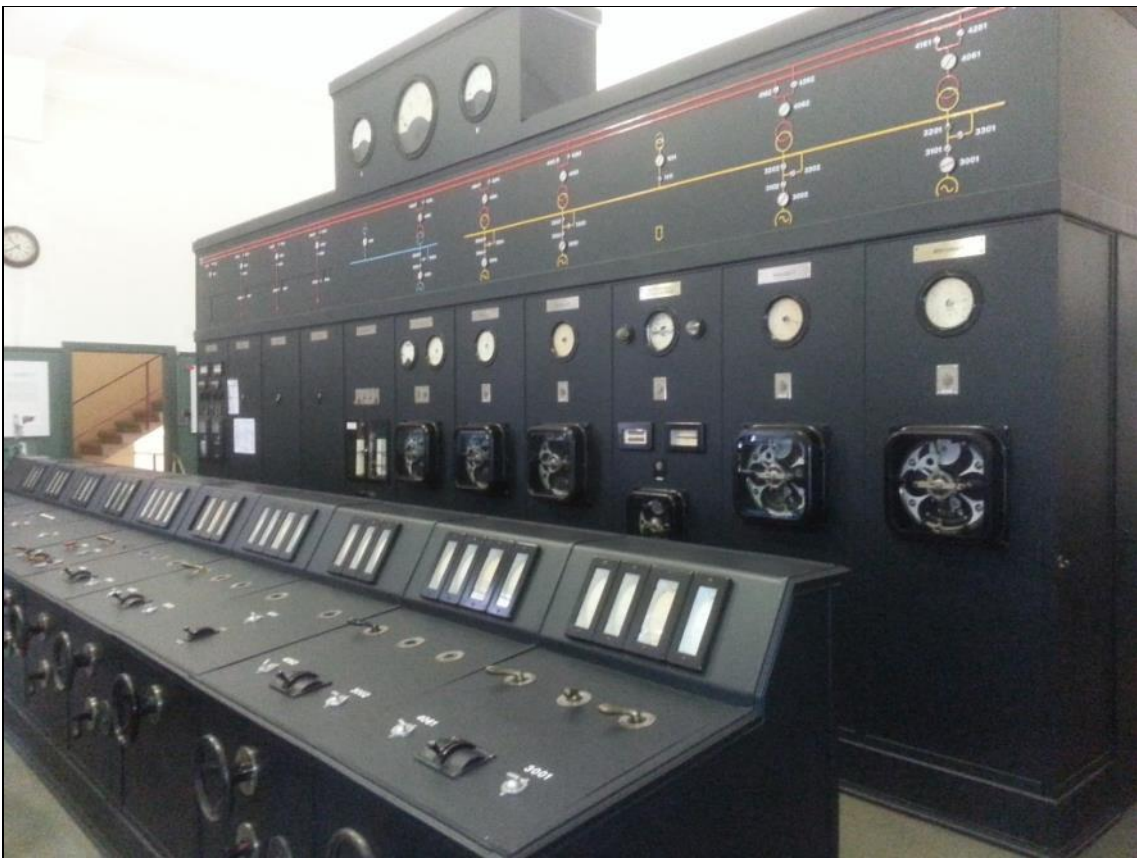
Il quadro comando della vecchia centrale FFS di Châtellard
