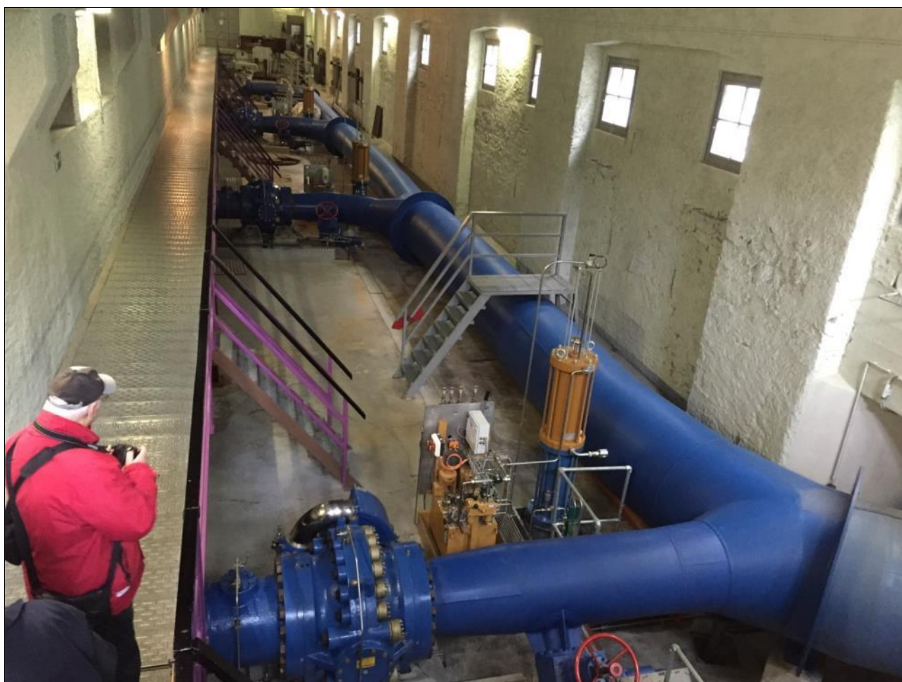
Centrale FFS di Châtellard
