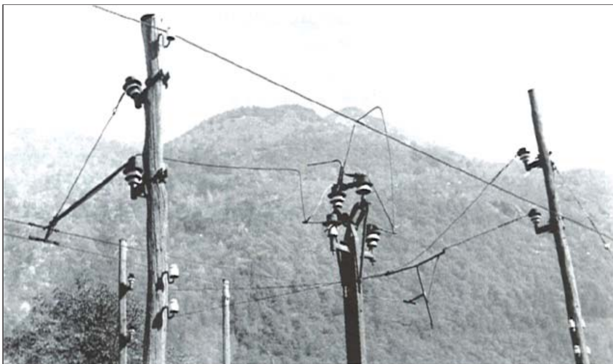
Dettagli del sistema di alimentazione della catenaria con al centro un interruttore di sicurezza. Alla catenaria erano allacciati i trasformatori per alimentare i villaggi lungo la linea ferroviaria. In basso gli isolatori della linea telefonica di servizio.
