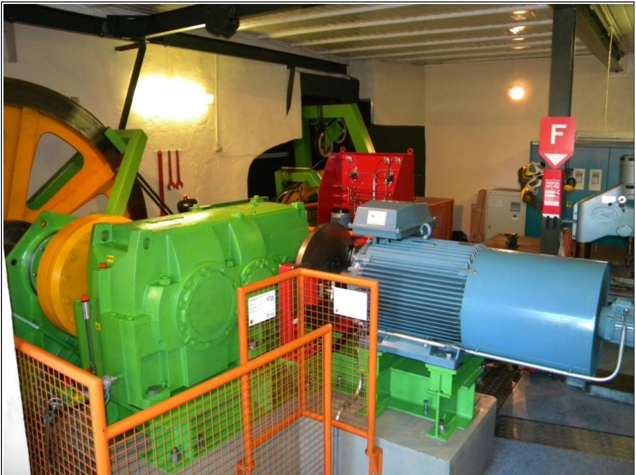
sala motori presso la stazione intermedia a Pazzallo
